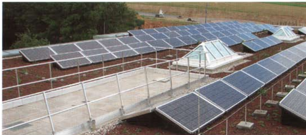
Die Fotovoltaikanlage auf dem Dach des Schulgebäudes ist für Schüler und Lehrer zugänglich.
