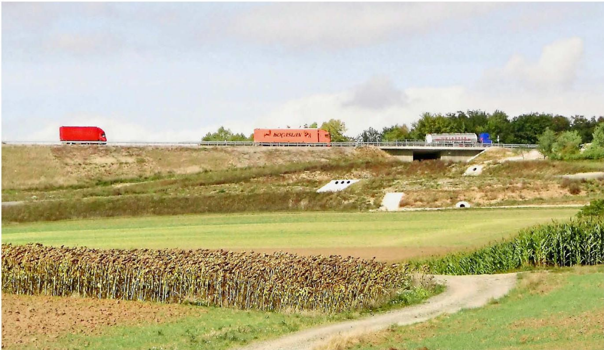
Neben der A 3 entsteht zwischen Helmstadt und Holzkirchhausen auf einem Kilometer Länge eine Photovoltaikanlage, die von der Bessenbacher Firma Main-Spessart Solar gebaut und von Anliegern teilweise mitfinanziert wird.
