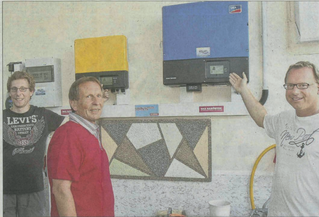
Stromerzeuger Willi Frank (Mitte) mit seinen Söhnen Marcel (links) und René vor den Wechselrichtern in der Halle. • Foto: Petrat
